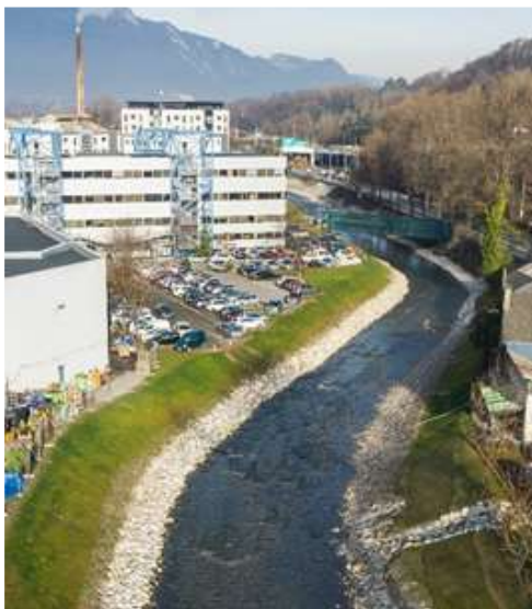
Augmentation de la section de la rivière dans un secteur inondable en février 1990. 2015.
